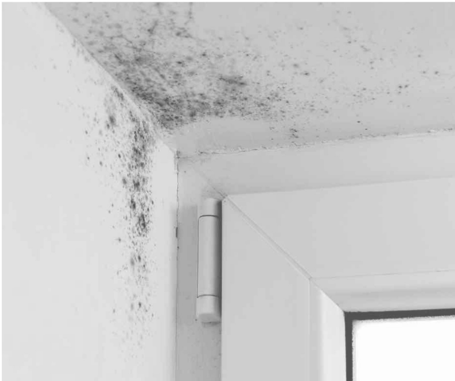
Figura 6 Formazione di muffe a seguito shock termico dovuto al raggiungimento del punto di rugiada in prossimità di un ponte termico - Fonte: Candidato (ATP 1514 / 2015 Tribunale Monza)
